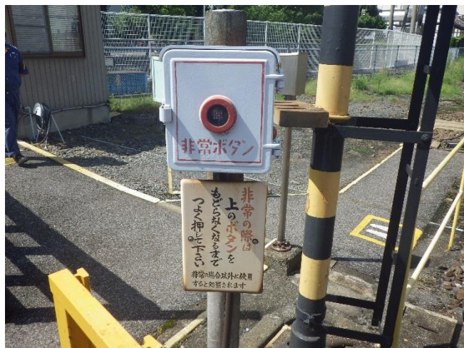
押ボタン式踏切道支障報知装置
