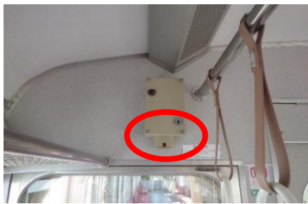
車内非常通報装置
