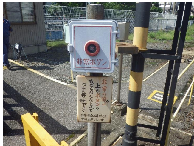
押ボタン式踏切道支障報知装置
