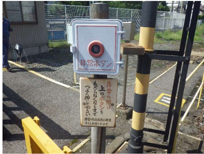
押ボタン式踏切道支障報知装置
