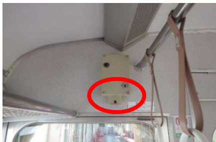
車内非常通報装置
