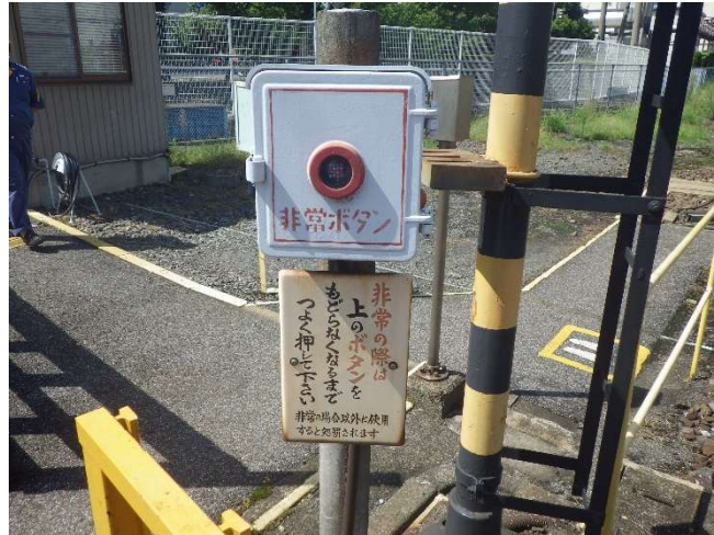
押ボタン式踏切道支障報知装置
