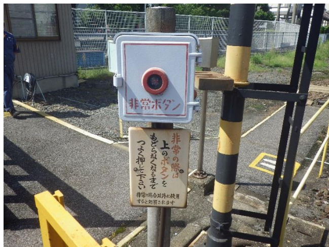
押ボタン式踏切道支障報知装置
